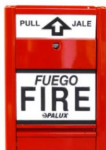
Figura 12: Alarma contra incendios
