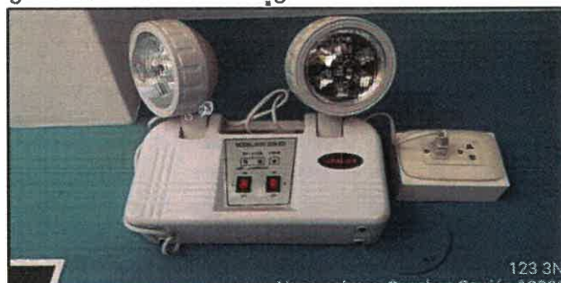
Figura 5: Luces de emergencia instaladas en el local SL01.
