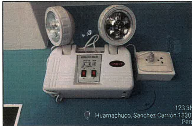
Figura 5: Luces de emergencia instaladas en sede SL02.
